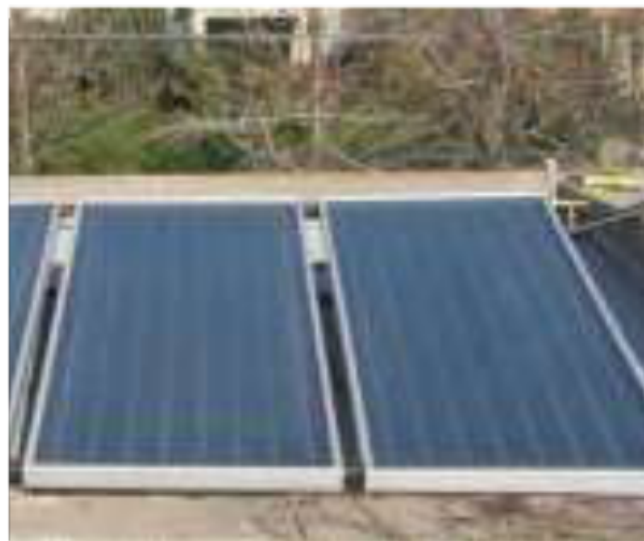
Colectores de Placa Plana
